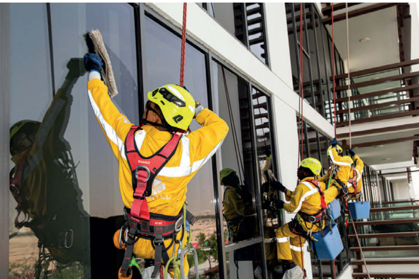
Façade cleaning rope access operations. Operaciones de limpieza con cuerdas en fachadas. Dubai, UAE (courtesy of Emrill Services, ph. Teddy Arago).
