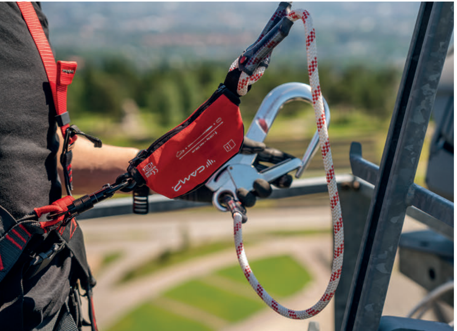
Torbjørn Solheim doing maintenance operations at the famous Holmenkollen ski-jump structure. Torbjørn Solheim realiza tareas de mantenimiento en la famosa estructura para el salto de esquí de Holmenkollen. Oslo, Norway (courtesy of Varri AS, ph.Kyrre Buxrud).
