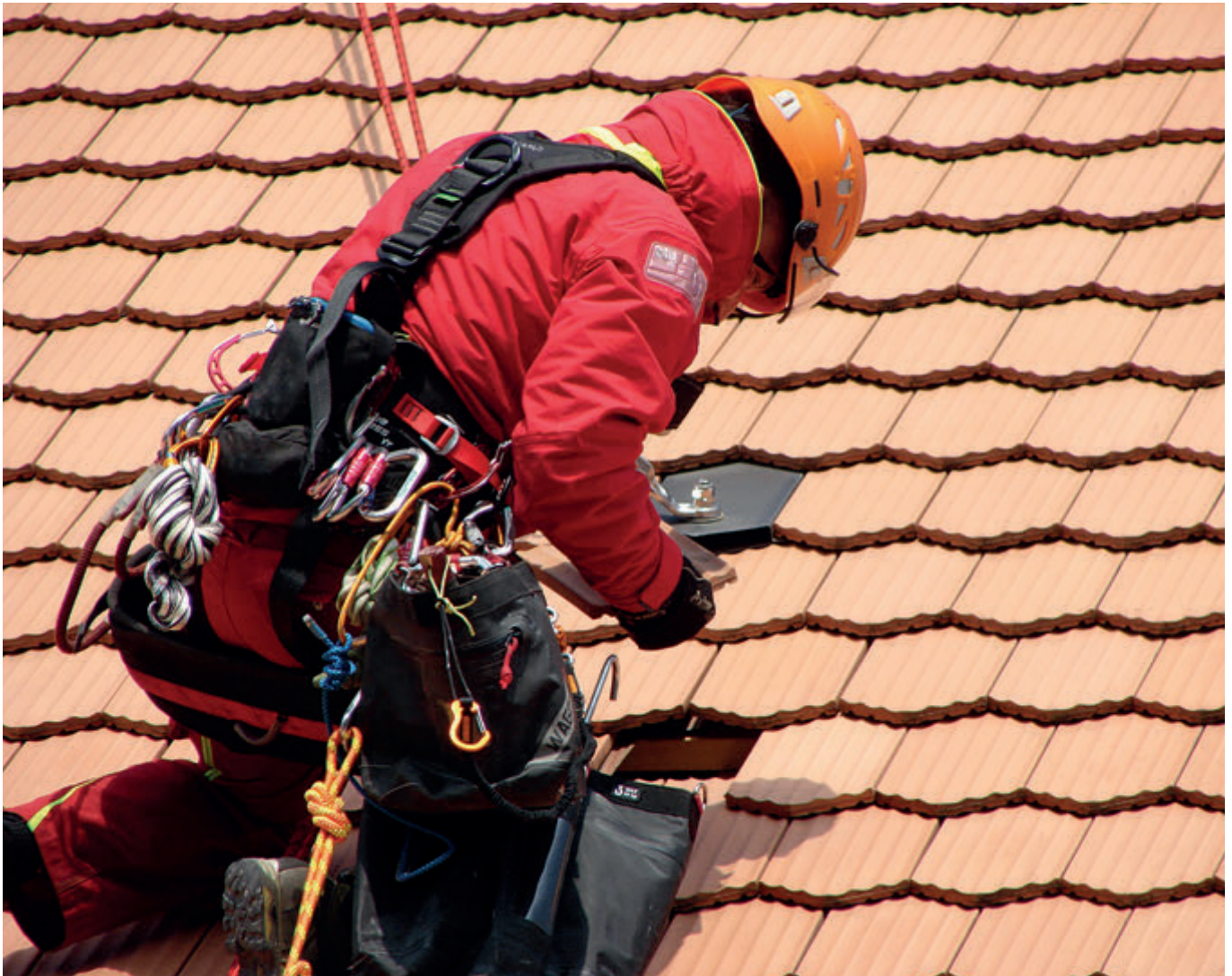
Work on the roof of the parliament of the canton of Vaud. Trabajos en el tejado del Parlamento del cantón de Vaud. Lausanne, Switzerland (courtesy of Corde-Access SA, rigger Andrea Giazzi, ph. Corde-Access SA).
